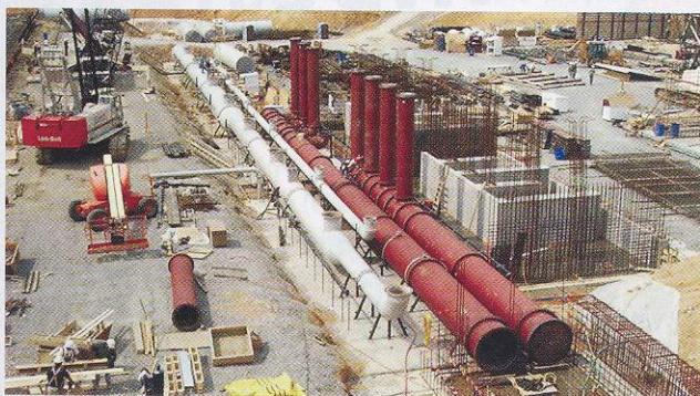
美国华盛顿州大古力水坝 The Grand Coulee Dam in Washington State, US
